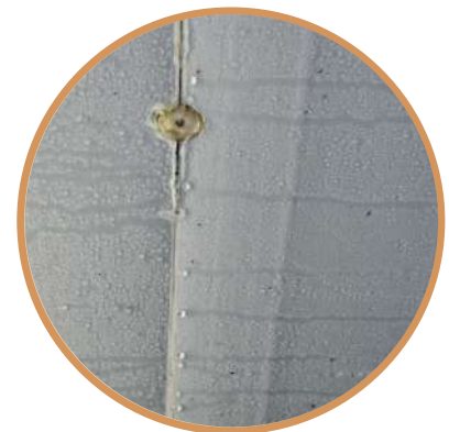
12 Condensación en los coolers
